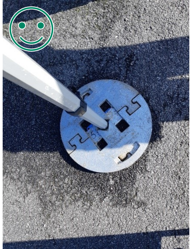
Kuva 4 HYVÄ TAPA. Kaksi kerrosta painoja vastasuuntaisesti. Lukitsevat kerrokset tolpan ympärille, kun tolpan aluslevy on riittävän kokoinen ja kiinteä. Kulmatolpan maajalan tulee kestää kyseinen paino.
