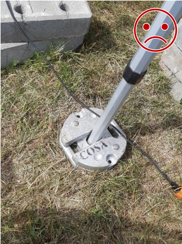
Kuva 1 EI NÄIN. Painojen lukitus toisiinsa puuttuu. Painot irtoavat painovoimaisesti, eivätkä pysy tolpan ympärillä tuulen ravistellessa teltaa.
